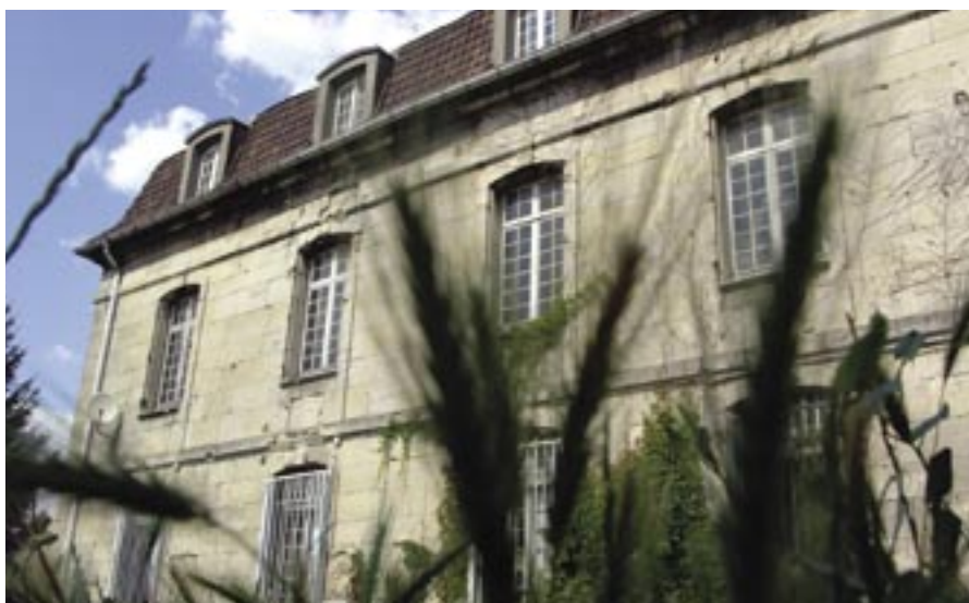
L'actuel foyer tel qu'il était avant d'être victime, début septembre, d'un incendie qui n'a fait aucun blessé. Tous les résidents ont été relogés.
